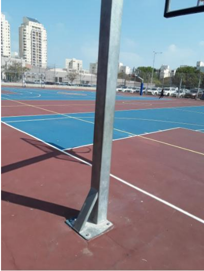
3.59-26/2/2023 -מגרשי ספורט-מתקני כדורסל יהיו יציבים וללא סימני פגיעה-1-מגרש ספורט-חוסר מיגון לאחד מעמודי הסל- - - 12:04
