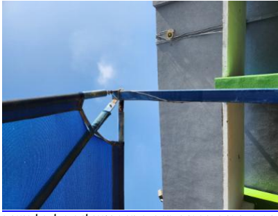
החצר תאורגן באופן 2-חצר בית הספר-חיבורי הסככה ננועים בחלודה. סכנת התפתחות קורוזיה הרסנית וקריסת הסככה - - - 3.11-23/1/2023 23: 58-ארגון החצר.-שיבטיח בטיחות מרבית בעת תנועה ופעילות של תלמידים
