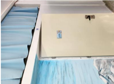
הדלתות תצוידנה באבזר או באבזרים לצורך המטרות 1-חדרים 13 ו 14.-לא נמצא מגן אצבעות בצד השני של הדלתות- - - הבאות: א. מגן אצבעות בשני צידי הצירים באזורים שבהם יש אפשרות להילכדות אצבעות. ב. האטת אגף הדלת במהלך סגירתו. ג. מעצור דלת במצב פתוח. האבזר יותקן בקיר, בגובה 5.23-24/1/2023 0: 09-דלתות-אגף הדלת ולא ברצפה. ד. במקלט ובמרחב מוגן יש להתקין מגן אצבעות ואלמנט קיבוע שיותאם לדלת. ה. בדלתות קלות של שירותים נדרשת הגנה מתאימה
